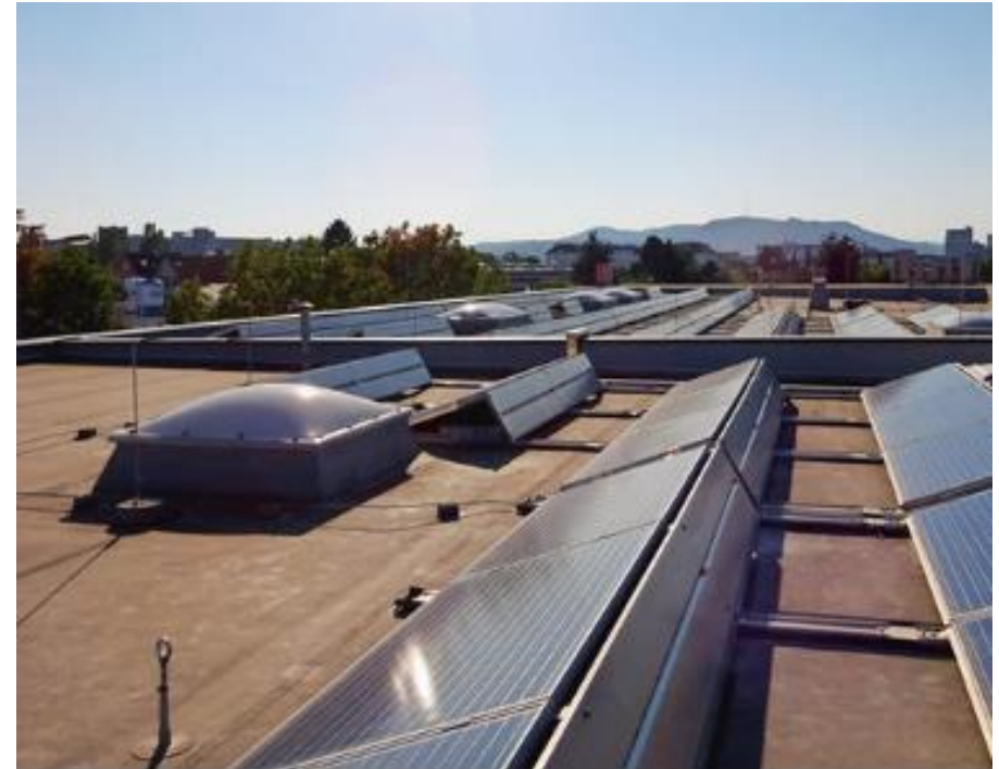
PV-Anlage mit geschlossener Unterkonstruktion auf einem hölzernen Flachdach. © Holzforschung Austria
